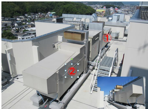
※自家発電 750kVA×2 台
