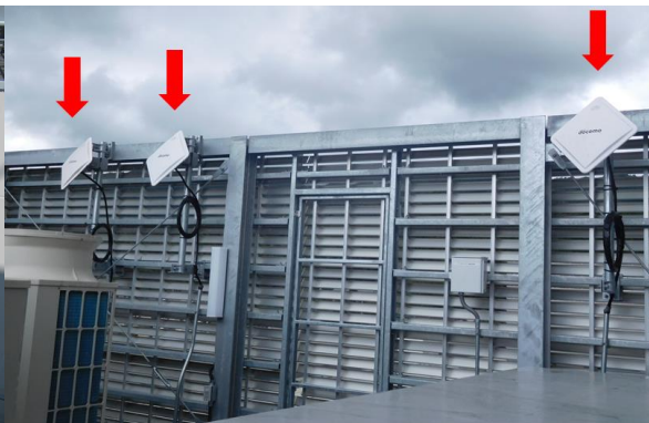
※衛星電話用に 3 回線アンテナ常設
