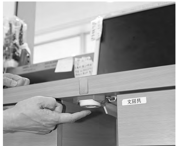
図5 救急外来の緊急連絡用非常ボタン
